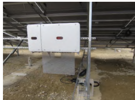
Exemple d'onduleur décentralisé (source : NEOEN)
