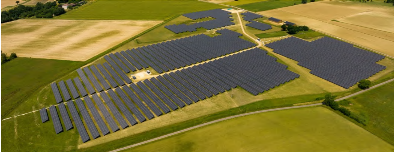
Centrale solaire de Bioule (82) (source : NEOEN)
